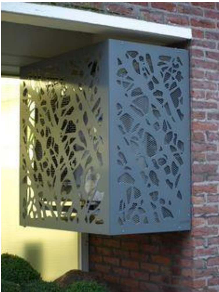
Buitenunit aan gevel gepersonifieerd
